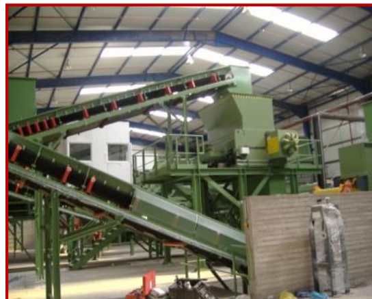
Εγκατάσταση επεξεργασίας RDF για ενεργειακή αξιοποίηση (WTE project) (Ασπρόπυργος 2009)
